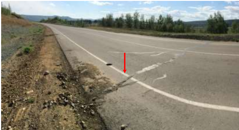
Деформирующийся участок федеральной автотрассы «Чита-Хабаровск»
